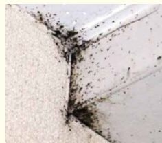
天井や壁の被害
